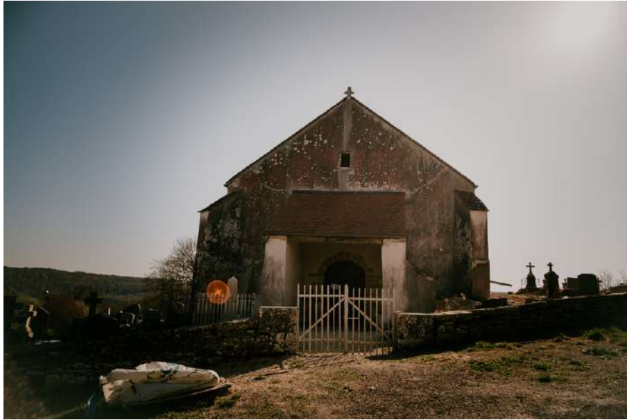
Façade ouest avec ses moisissures rouges
