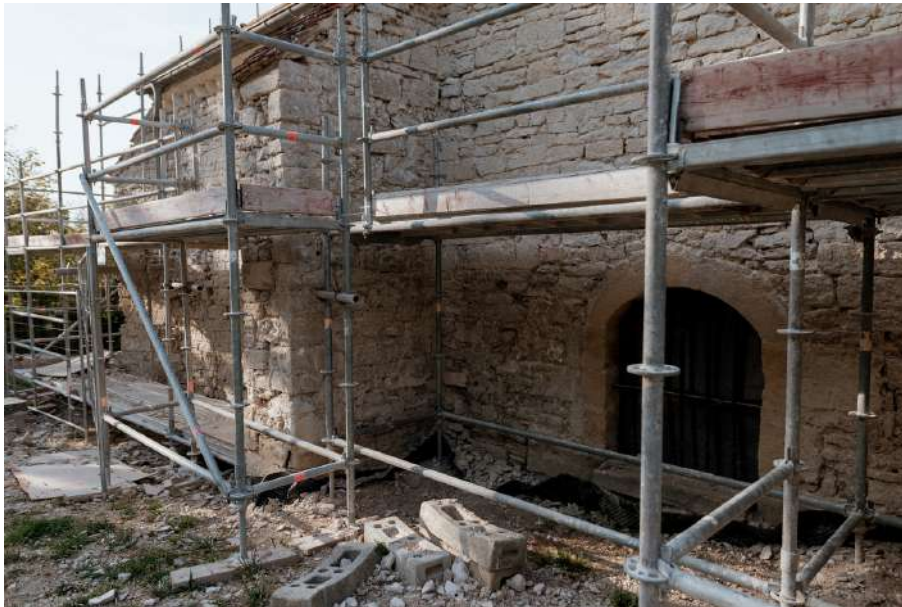
Pierres gelées découvertes sous l'enduit ciment
