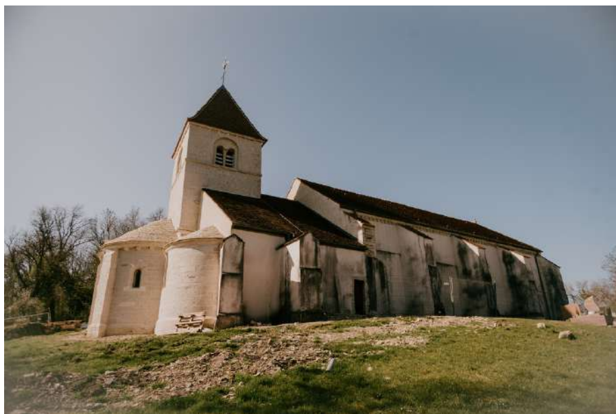
Façade nord avec ses moisissures noires
